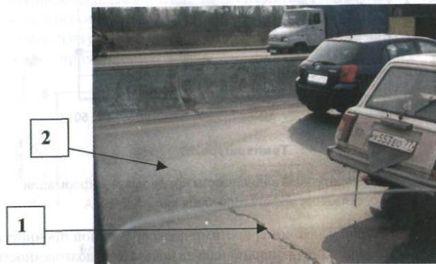
Рис. 42. Вид отраженной трещины на поверхности покрытия МКАД из асфальтобетона типа А (1) и ЩМА (2)
