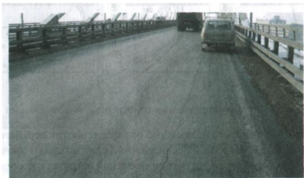
Рис. 61. Продольная трещина вдоль балки моста
